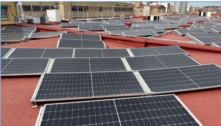
Imagen de la instalación fotovoltaica de la sede central
